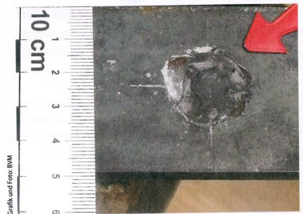
Detail einer Schweißnaht. Aufgrund unsachgemäßer Schweißnahtvorbereitung und nicht fachgerechter Schweißung hatten die Schweißnähte versagt.
