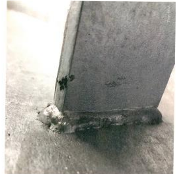
Diese Nahtüberhöhung wurde vom Auftraggeber bemängelt. Mit mehr als zwei Millimetern lag diese tatsächlich über dem in diesem Fall erlaubten Grenzwert von 1,75 Millimeter.
