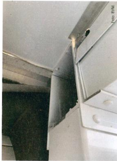
Die Abdeckung, die das obere Tragprofil verschließt, fehlt.
