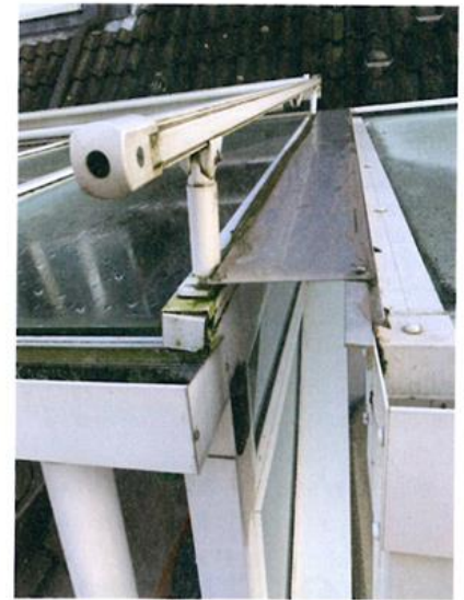
Der etwa dreißig Zentimeter breite Abstand zum Terrassendach des Nachbarn ist mit einem unbeschichteten Aluminiumblech abgedeckt. Die Verklebung auf dem Nachbardach hat sich bereits großflächig gelöst.
