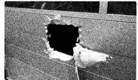
Schadensbild an Sektionaltor nach manuellem Angriff auf die Führungsschiene
