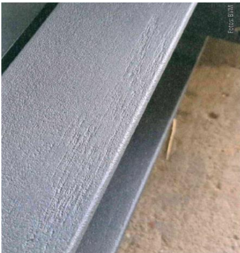
Die größte zulässige Tiefe der Ungenzen auf dem Walzprofil durfte nach DIN EN 10163-3 1,2 Millimeter betragen und wurde an keiner Stelle der Oberfläche (hier auf dem Flansch) erreicht.
