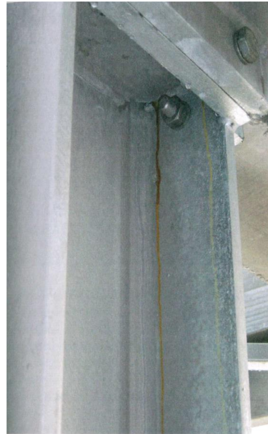
Solche rostbraunen Verfärbungen auf der Zinkoberfläche entstehen durch unvollständig verzinkte unsauber ausgeführte Schweißnähte. Der Rost läuft aus den unverzinkten Poren.
