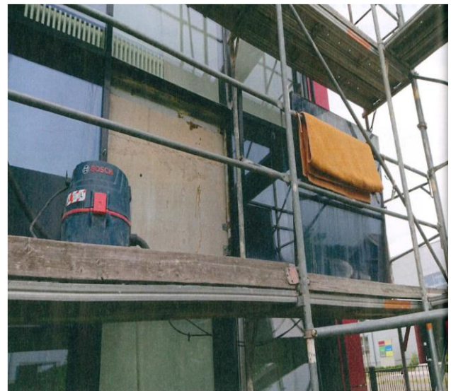
Die geschädigte und geöffnete Fassade mit den Ablaufspuren an den Paneelen.
