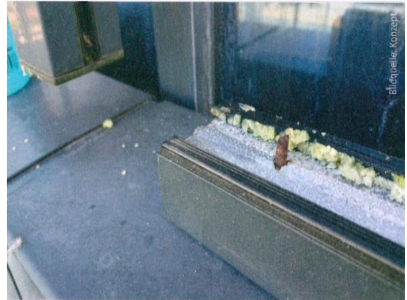
Erstaunliche Wirkung des aggressiven Chlorgases: Ausblühungen und komplett durchgerostete Edelstahlschrauben
