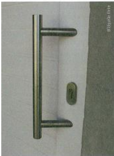
Die beanstandeten Türstoßgriffe an den Haustüren und Nebentüren.
