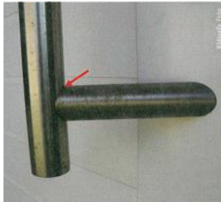
Die Korrosion ist schon nach einem Jahr auf der gesamten Oberfläche zu beobachten. In den Spalten entstand durch Verarbeitungas-
